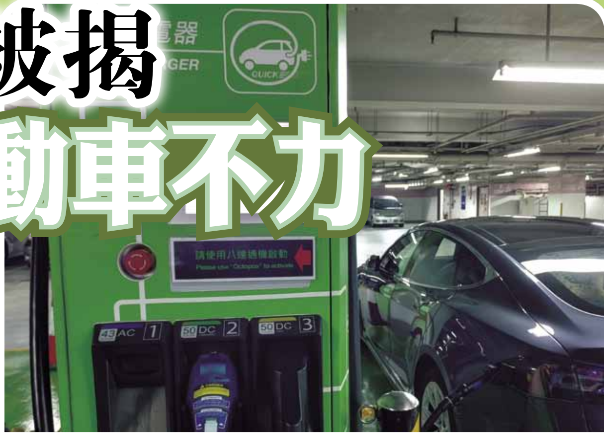
申訴專員公署上月發表報告揭示電動車公共充電設施不足。
