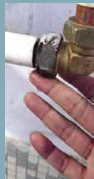
水管滲漏令人不勝煩擾。
