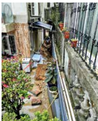
尚賢花園有磚牆倒塌，壓向旁邊村屋。
