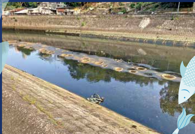
林村河近錦山對開出現多個坑洞。
