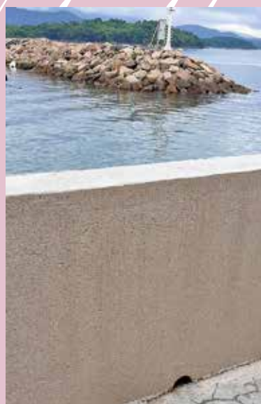
泰湖閣現有擋浪牆，亦建議加高加固。
