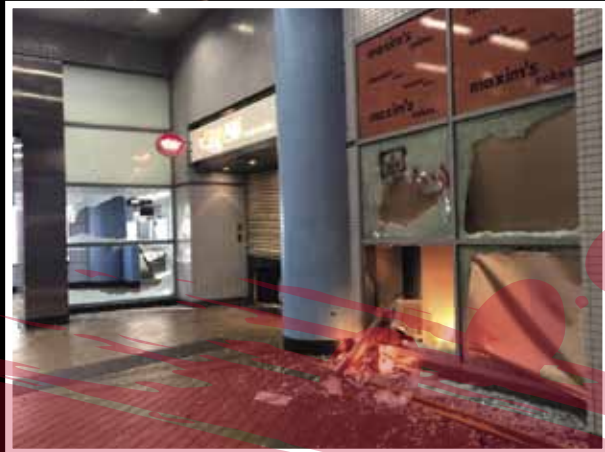
坑口站曾被縱火焚毀。
