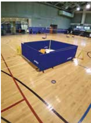
大埔墟體育館常現漏水問題。
