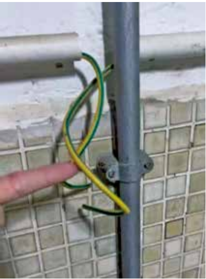
屯門山景邨3月發現大廈後樓梯接地銅線被盜。
