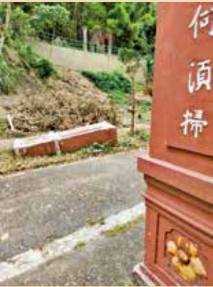
寺內有牌樓倒塌後未見復修。
