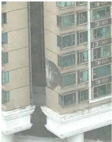
深井碧堤半島有樓宇外牆剝落。
