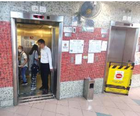
宜逸樓電梯老化情況較嚴重。
