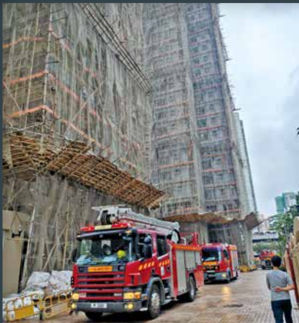
12月1日怡樂花園發生火警，居民緊急疏散。
