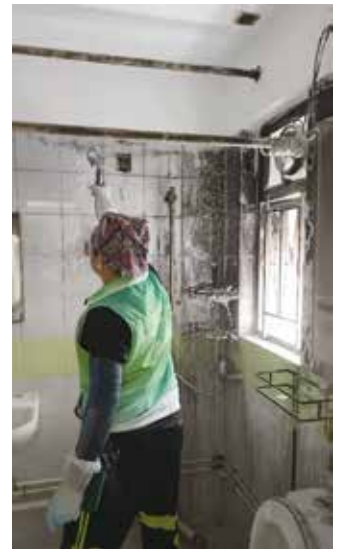
熏黑的牆壁終於恢復潔白。
