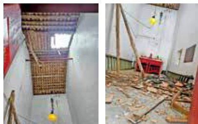
近期夏季風雨頻繁，加劇了建築物的損壞情況。
