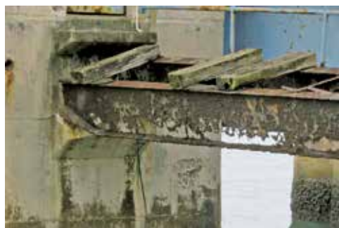
近年碼頭日久失修，鋼鐵結構出現銹蝕。
