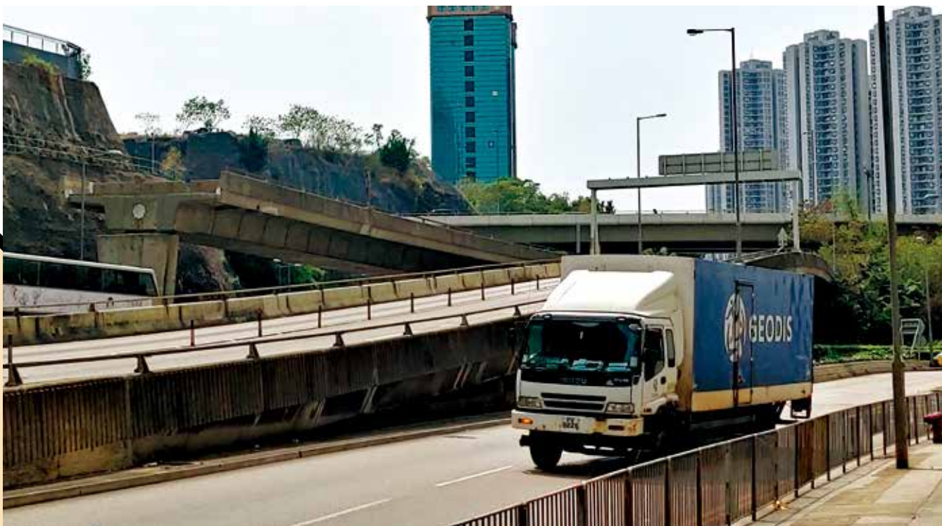
荃青交匯處上方的天橋接駁斷橋口，間置已達 25 年。
