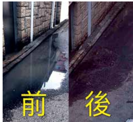
沙頭角舊消防局側的清水渠不斷有污水滲出，高維基已即時通知相關部門處理。
