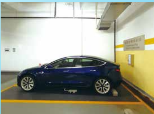
有電動車停泊在充電位，但未見插線充電。
