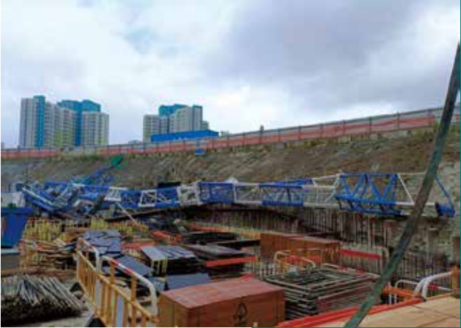
今年9月，安達臣道天秤倒塌導致三死六傷。
